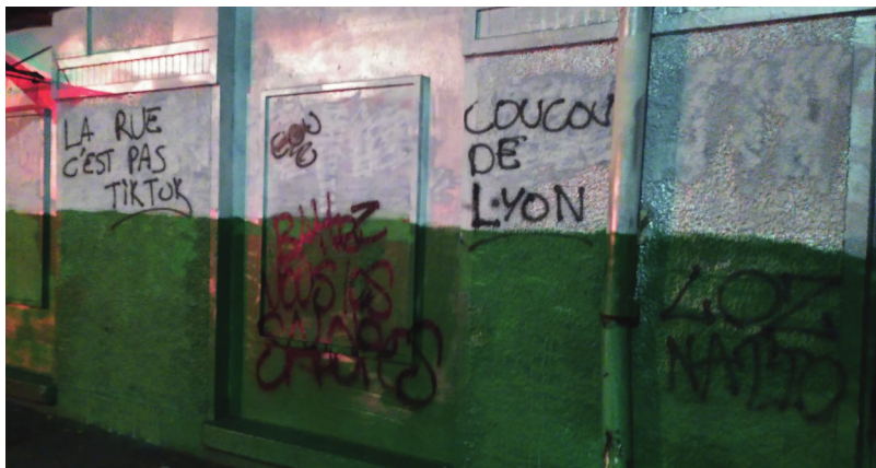
Façade de l'Espace Autogéré dégradée par des fafs, novembre 2024
